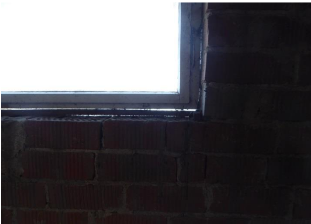
Abbildung 4: Weitere Einflugmöglichkeit in das Gebäude
